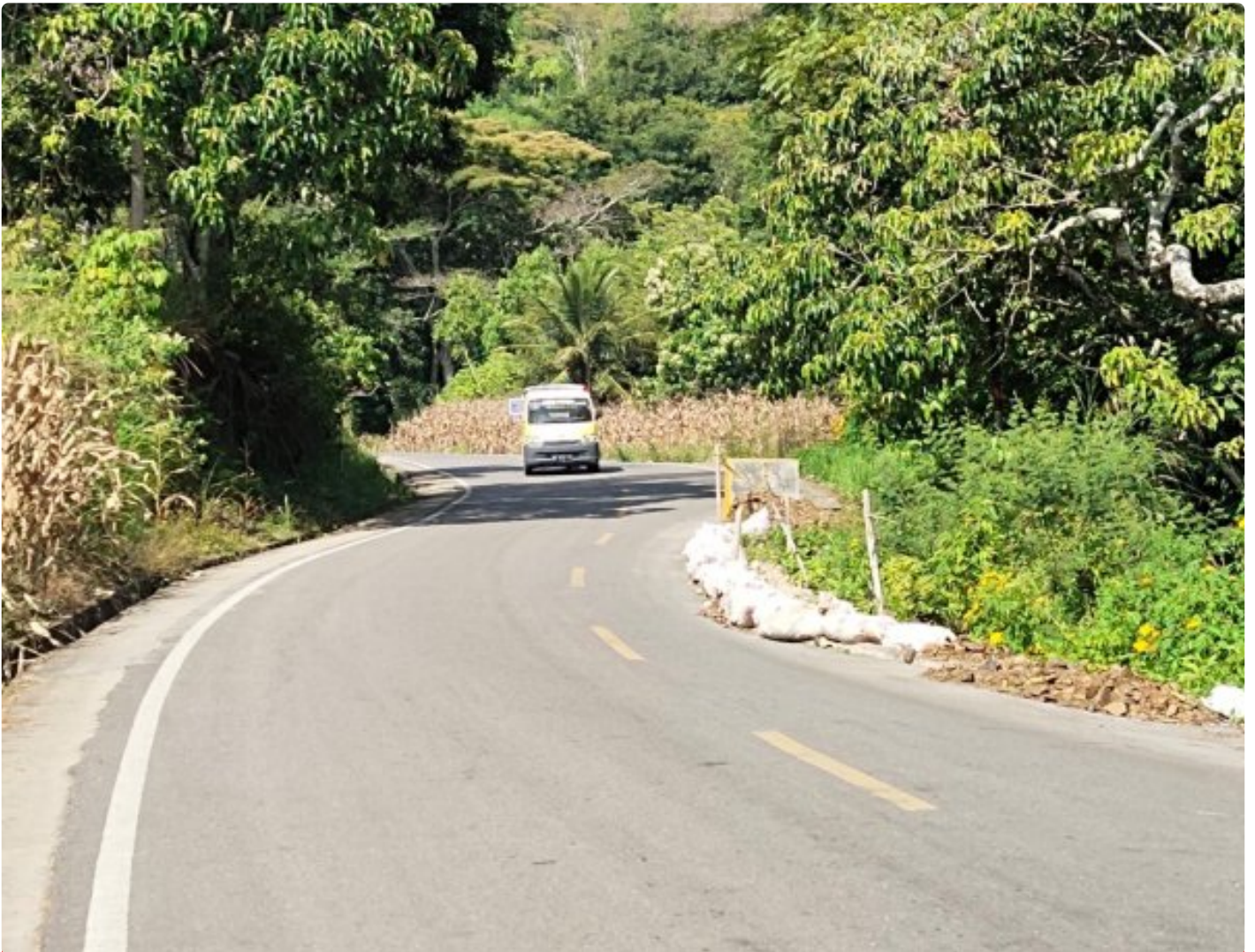
Bdan Jalan Amblas di Jalinsum Tomok-Pangururan Desa Marlumba Kecamatan Simanindo
